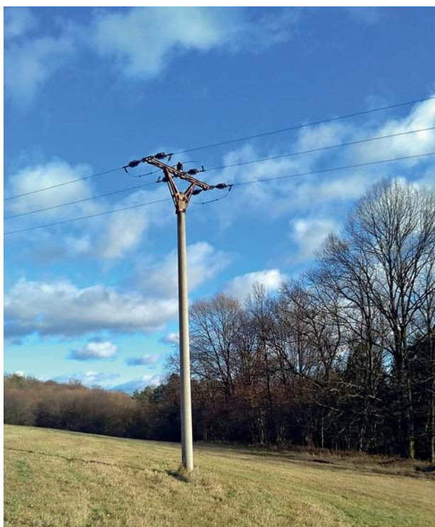
Obr. 5a Jednoduchý sloup vedení VN jako kontrolní bod
