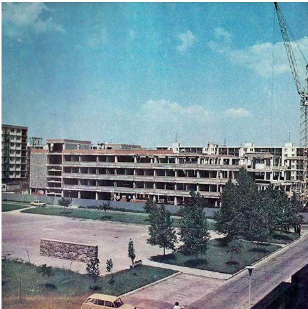
Obr. 1 Budova rezortu geodézie, kartografie a katastra počas výstavby (fotografia z knihy „25 rokov rezortu geodézie a kartografie“ z roku 1979 [3])
